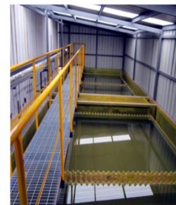
废水处理系统
