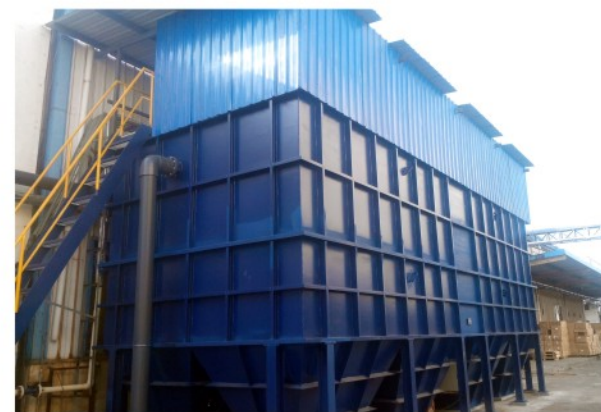
废水处理系统
