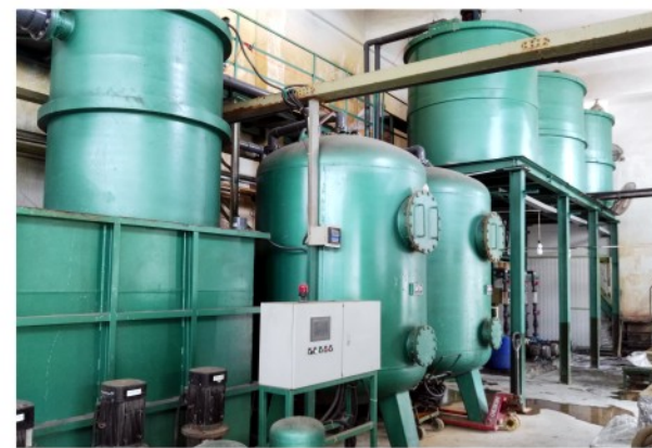
废水处理系统
